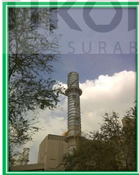
Gambar.8 cerobong Asap setelah pakai water spray
