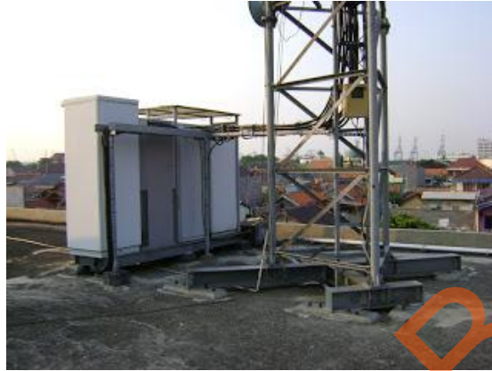
Gambar 3.1. Tower pada rooftop sebuah gedung
