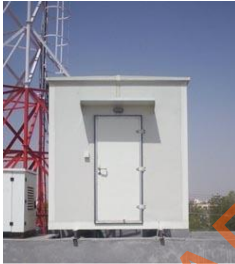
Gambar 3.9. shelter yang ada pada tower.
