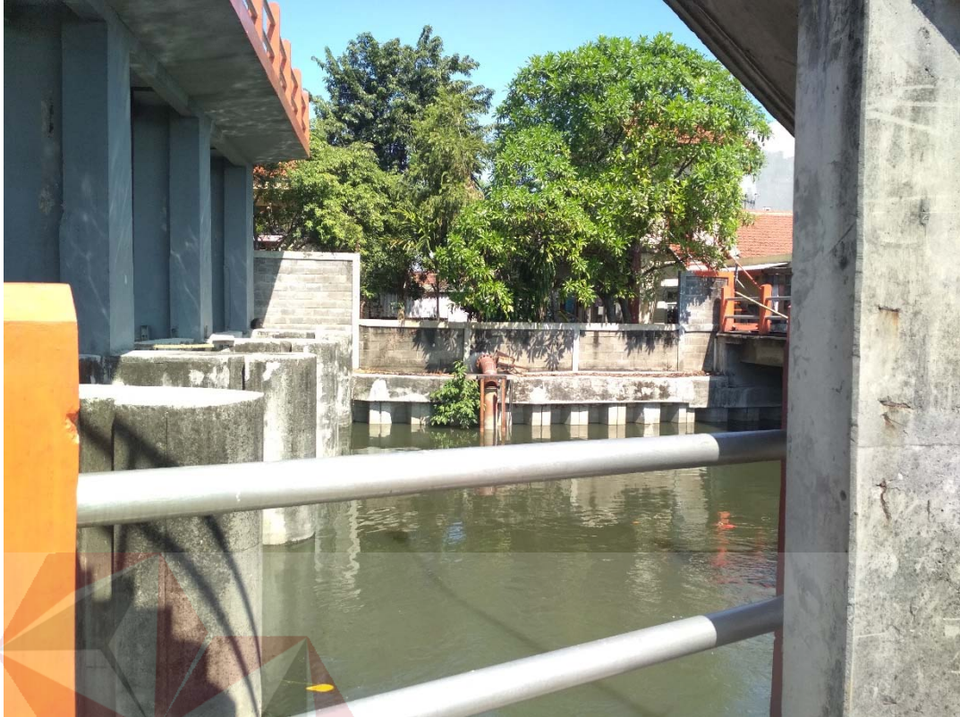
Gambar 1. 2 Pompa Selat pada Rumah Pompa
