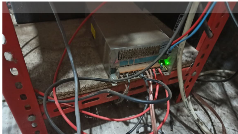
Gambar 4.19 Accu Genset Terhubung UPS
