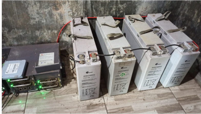
Gambar 4.20 Baterai Pada UPS
