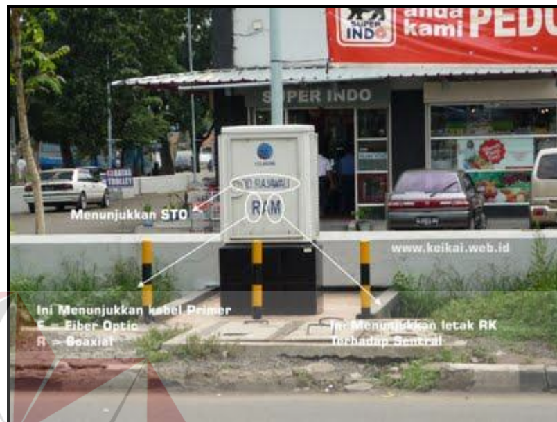
Gambar 3.3 Rumah Kabel (RK)
